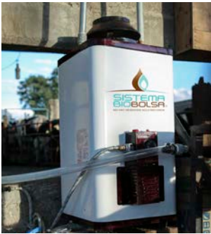
Biogás en calentador de agua
