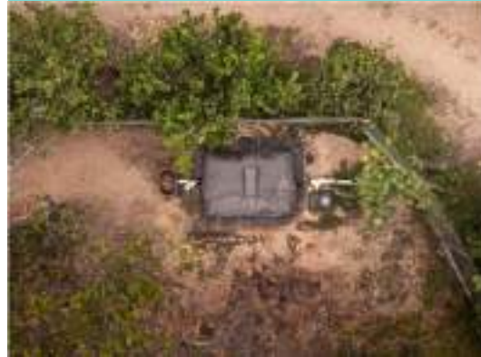
Sistema 8 Área Requerida: 3.4 X 6.2 m Biogás: 2.5 m 3 /día*
